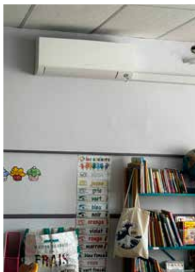
Nouvelle climatisation à l'école communale
