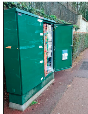
Exemple d'armoire de rue ouverte
